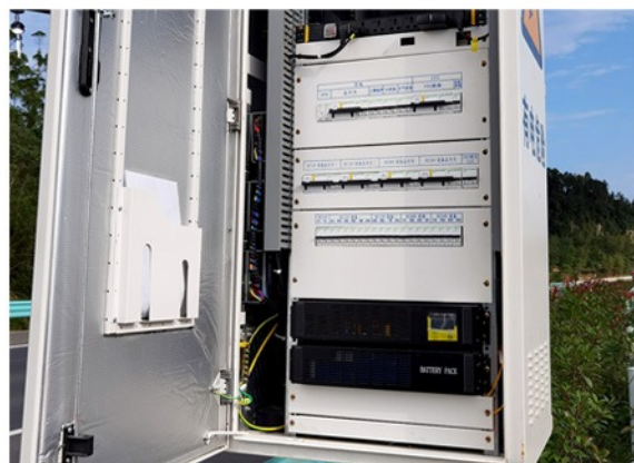
四川公路信号收发器及监控系统
