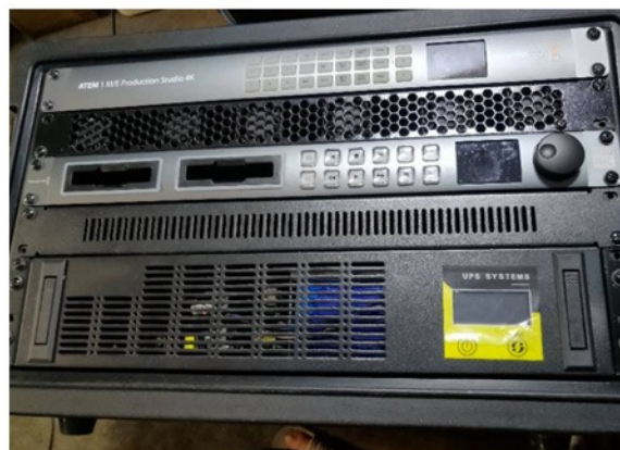
上海科技公司服务器机房
