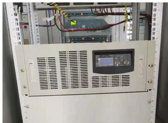
河南郑州市配电室
